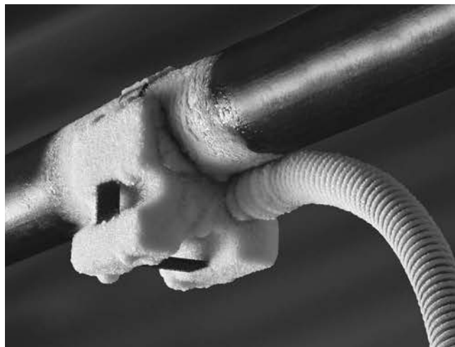
Slika 9 – Zamrzovalna glava zamrznjena na cev
