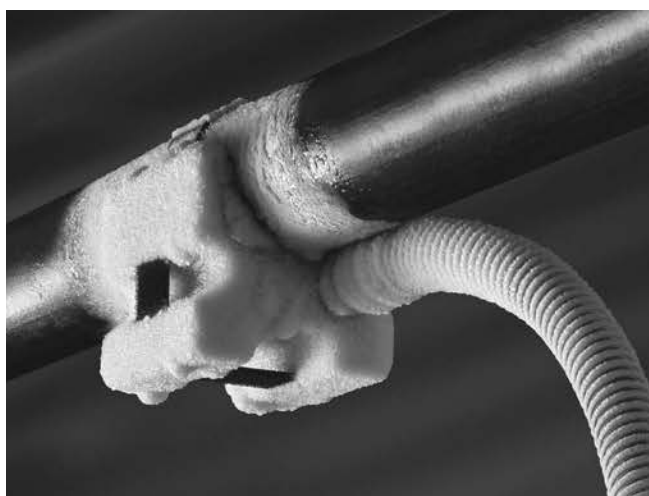
Rys. 9 – Głowica zamrażająca przymarznięta do rury
