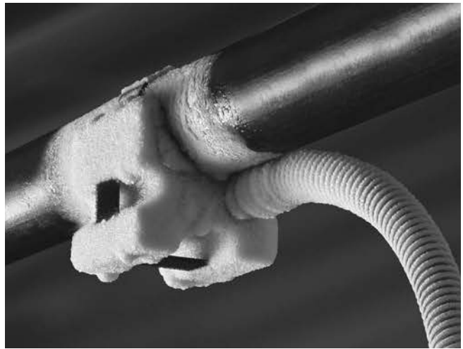
Figur 9 – Frysehoved fastfrosset på rør
